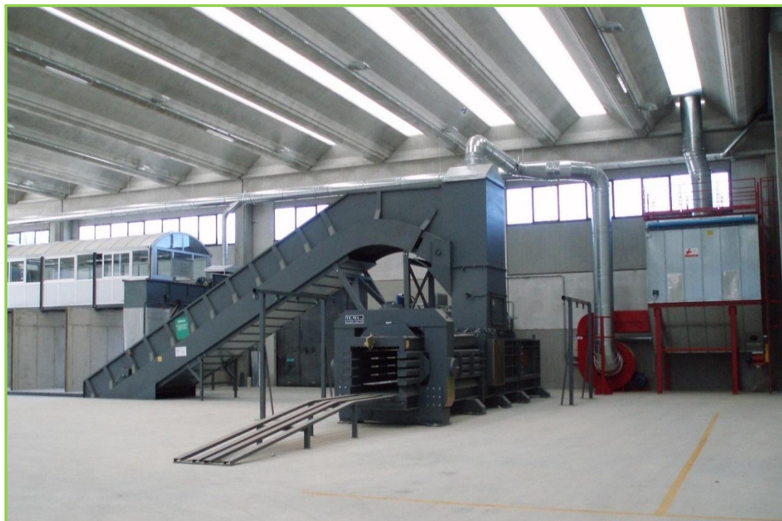
Figura 5: Impianto di selezione e pressatura
